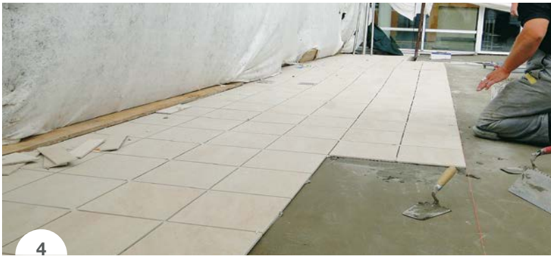
SLIKA 4: Polaganje zaključne obloge iz keramičnih ploščic v cementno lepilo KERAFLEX MAXI S1.
